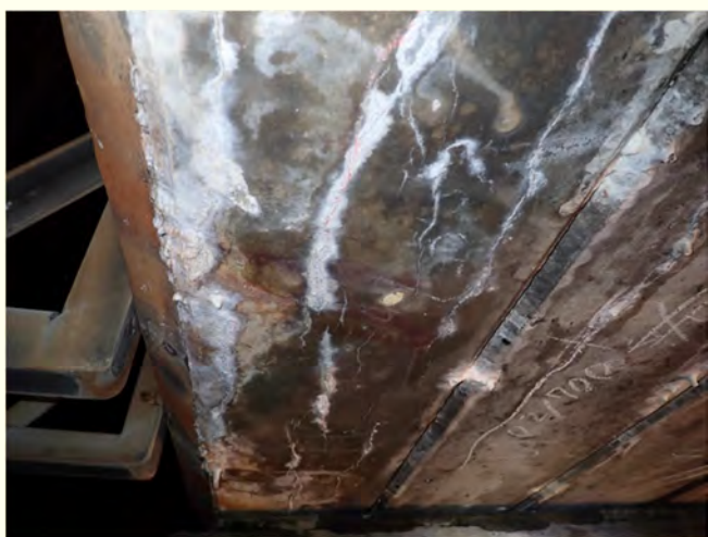
健全度Ⅲ：田端跨線橋
