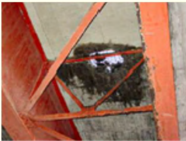
健全度Ⅳ：長野県点検要領より
