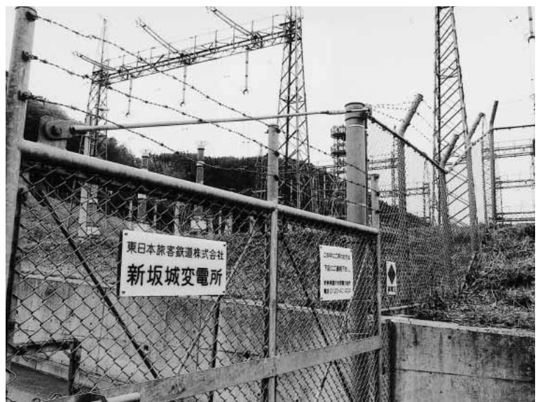
“税収見込める” 新幹線変電所
