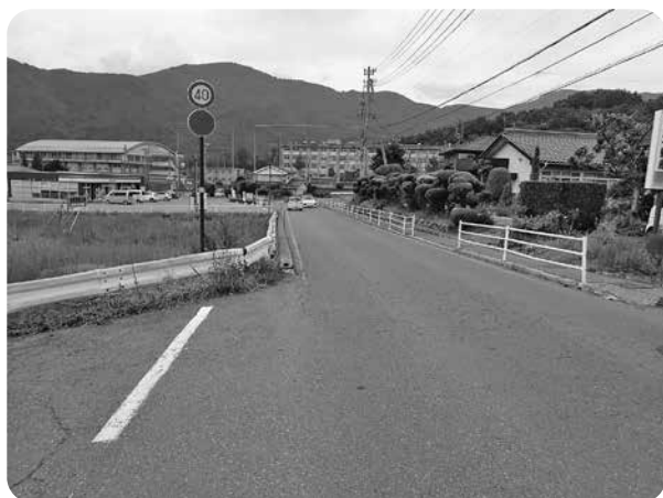
舗装修繕予定（御所沢）
