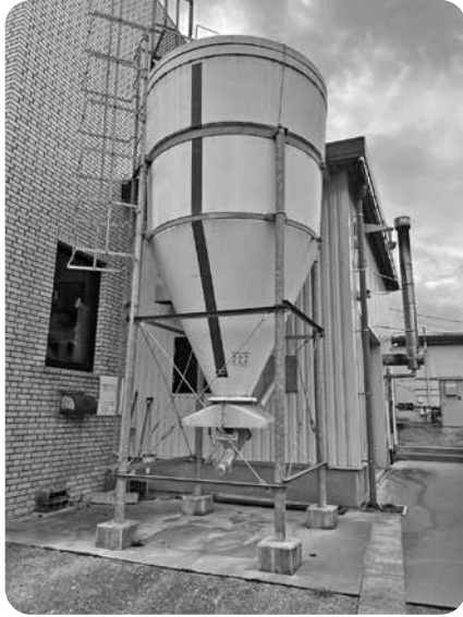
脱炭素に向けて (役場木質ペレットボイラー)
