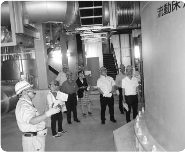
見上げる巨大な汚泥焼却炉
