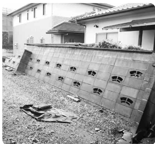
転倒したブロック塀 (長野県「ブロック塀の点検表」より)
